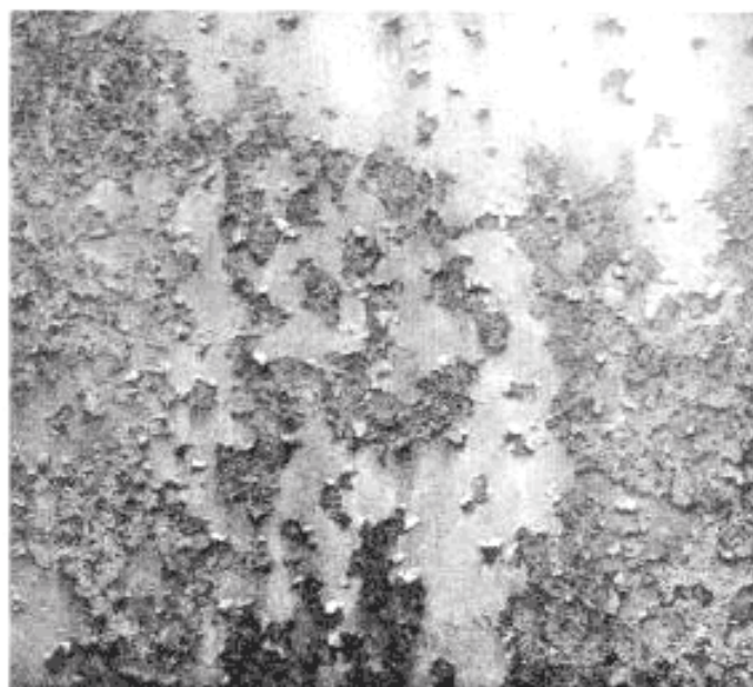
Рисунок 13 — Коррозия металла балл K5 (или R5)
