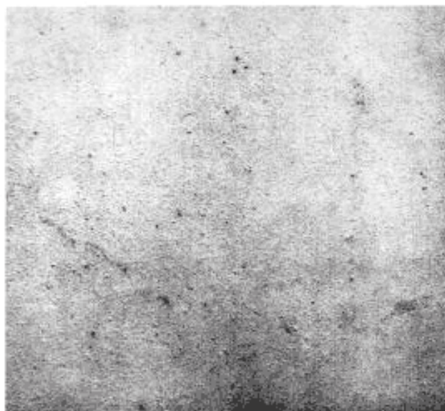
Рисунок 9 — Коррозия металла балл K1 (или Ri1)
